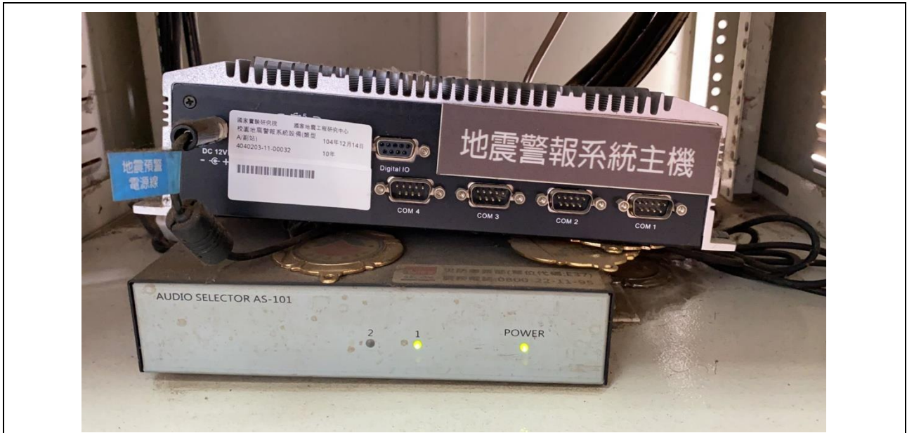
本校地震警報系統主機安裝於擴音設備
